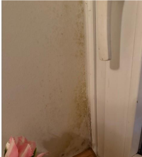
Bild 17: Feuchtigkeit Schimmel Gebäude- ecke, WEG 2 EG
