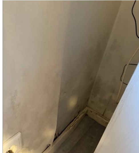
Bild 18: Feuchtigkeit Schimmel Außenwand
